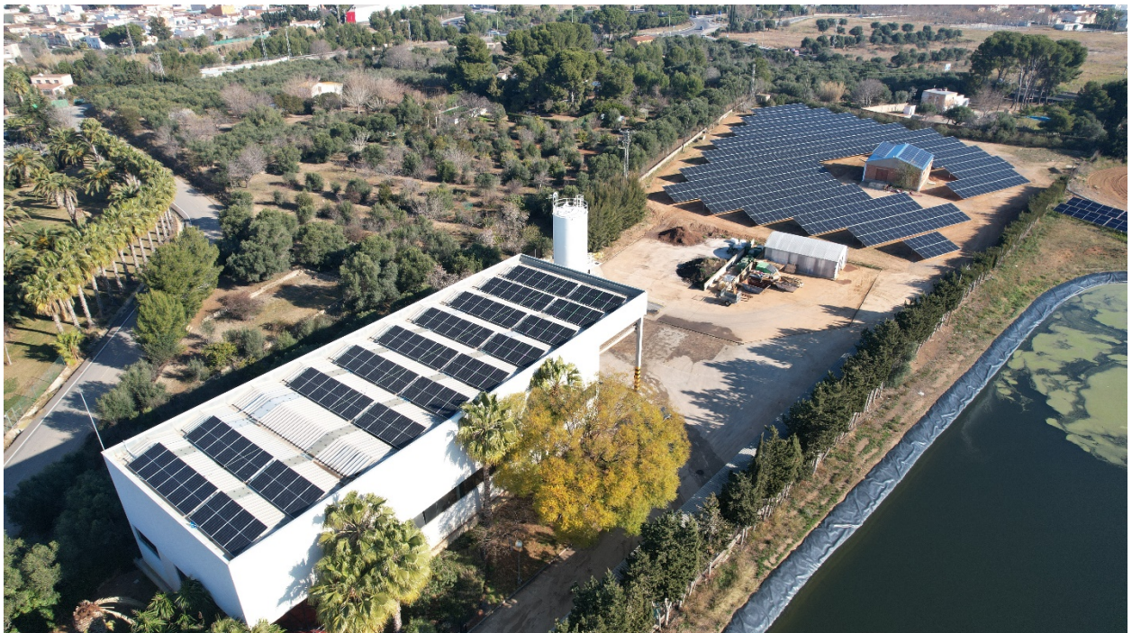
Figura 15. Vista aérea de la instalación fotovoltaica sita en la EDAR de Reus ( cubre un 33% de las necesidades energéticas de la planta)
