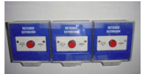
Activación compuertas cortafuegos / control exutorios / puertas automáticas
