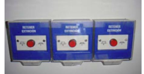
Activació comportes tallafocs / control exutoris / portes automàtiques
